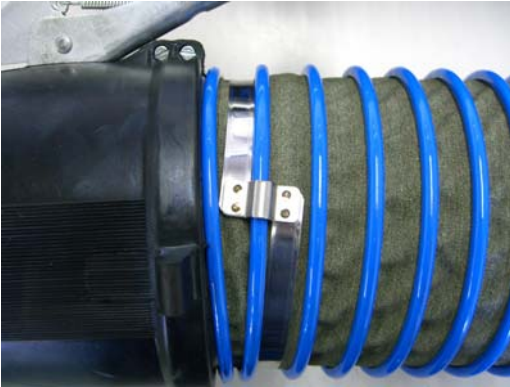
しっかりと締め付けられており、溶接部に変形がない状態 Fig. 5 (a)
